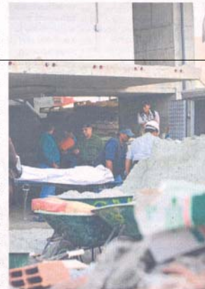
Tragedia. En la obra H2O ocurrió el accidente.
